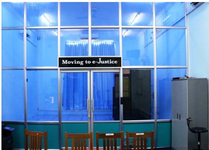
ပြည်ထောင်စု တရားလွှတ်တော်ချုပ်ရှိ Server Room အား Mini Data Center အဖြစ် ပြင်ဆင် ဆောင်ရွက်ထားရှိမှု
