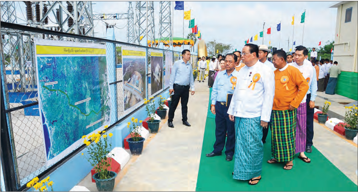
ပြည်ထောင်စုဝန်ကြီး ဦးဝင်းခိုင်နှင့်အဖွဲ့ ဓာတ်အားခွဲရုံ Control Room နှင့် Switchyard အတွင်း လှည့်လည်ကြည့်ရှုစဉ်။ သတင်းစဉ်
