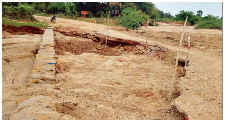
ညောင်ဦး-ငါးရောက်ကားလမ်း ချောင်းရေတိုက်စားမှုကြောင့် ရေကျော်ကွန်ကရစ်ပျက်စီးနေမှုကို တွေ့ရစဉ်။
