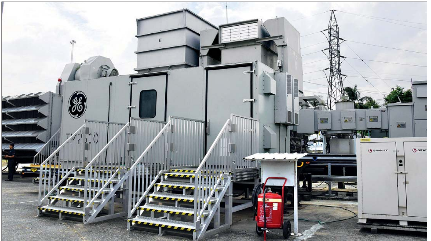
Trailer Mounted Dual Fuel Generator (TM 2500) ဓာတ်အားပေးစက်ကို တွေ့ရစဉ်။ သတင်းစဉ်
