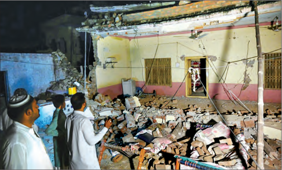
ငလျင်လှုပ်ပြီးနောက် အဆောက်အအုံထိခိုက်ပျက်စီးမှုကို တွေ့ရစဉ်။
