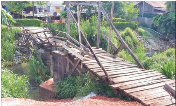
နမ့်ပေါ်ချောင်းကူးတံတား ကျကျပျက်စီးနေသည့်ကို တွေ့ရစဉ်။
